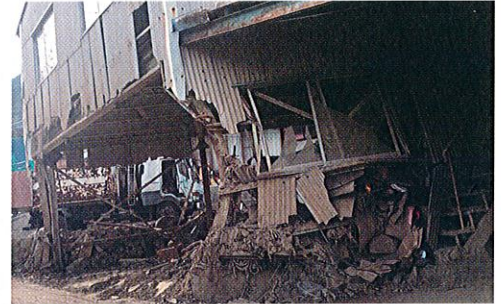
土砂が流れたと思われる道沿いの家は1階部分が全壊状態でした
